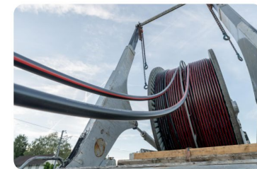
Investitionen ins Stromnetz prägen die Strompreise 2027
