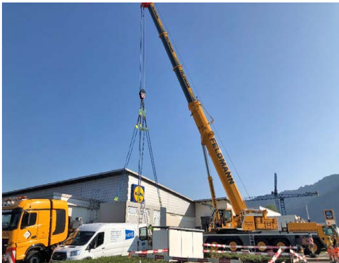
Trafostation Säumergut vor dem Versetzen
